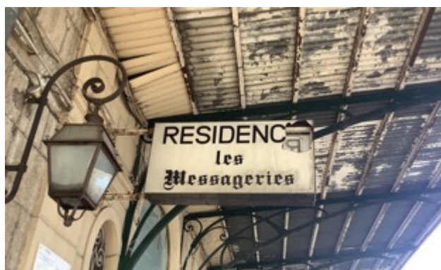
Enseignes perpendiculaires au mur en mauvais état de fonctionnement, Marmande, Novembre 2023.
