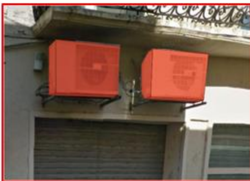
✗ Machinerie apparente sur façade
